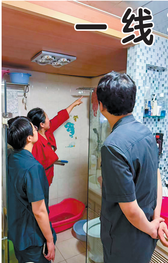
法官在当事人家中查看漏水情况。王艺霖 摄
